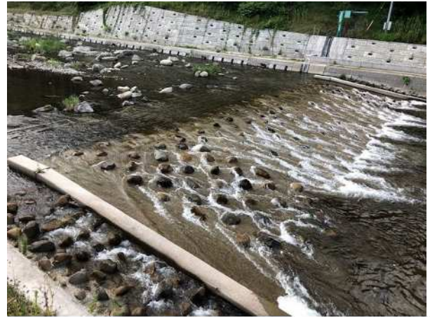
写真 54 魚道とスロープ（丸山地区 日野川）
