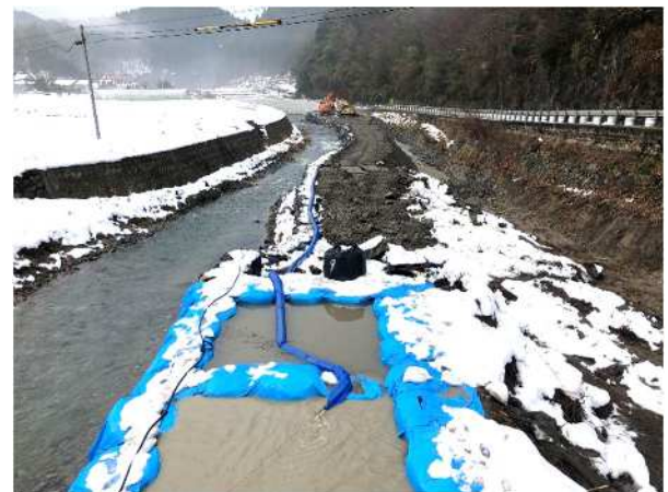
写真 57 沈砂池（河上地区 日野川）
