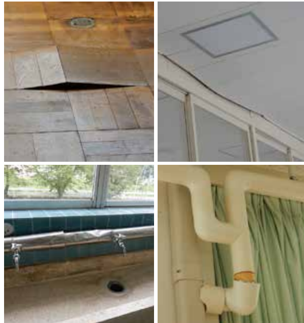
修繕が必要な中学校
