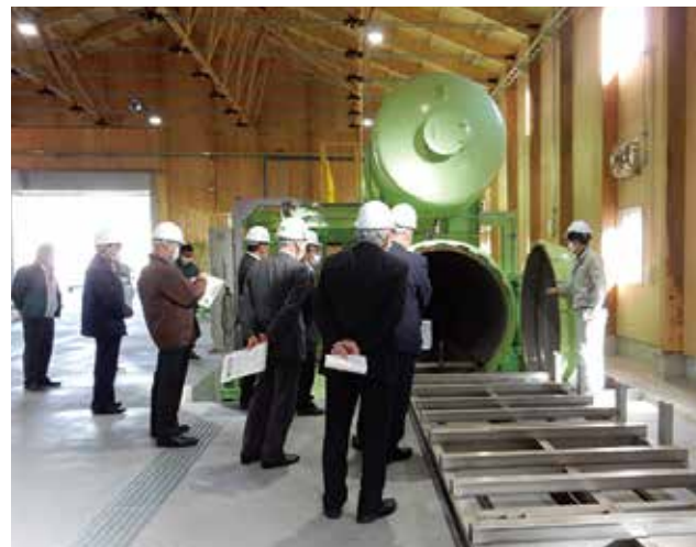
防腐・防蟻処理設備
