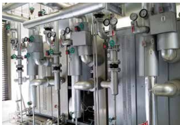
修理不能となった冷温水発生装置
