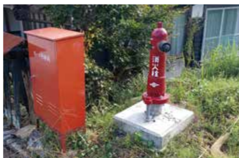
新設された消火栓
