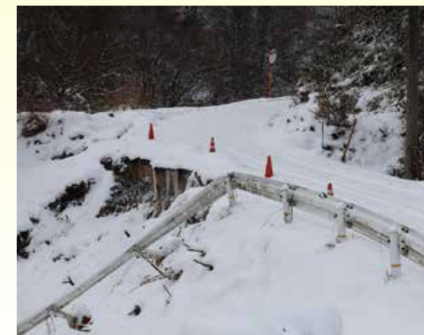
令和5年7月豪雨で災害で崩落した林道
