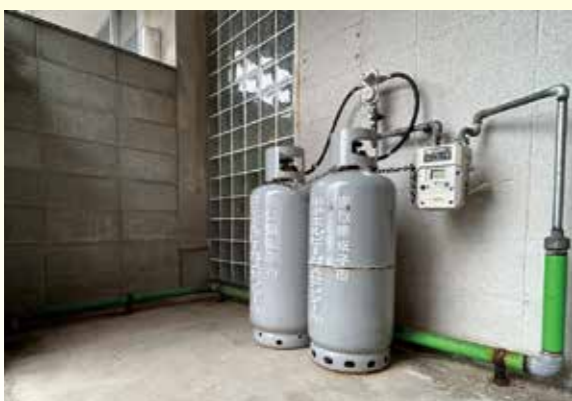
ガス漏れが疑われる地下配管
