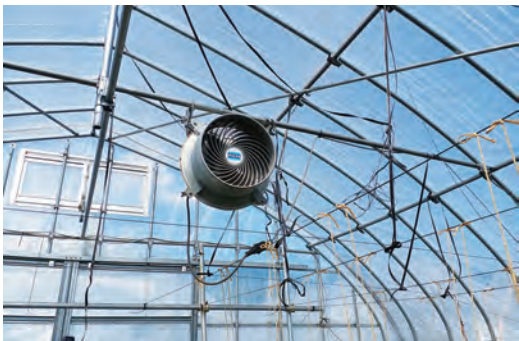
ハウスの高温対策用循環扇
