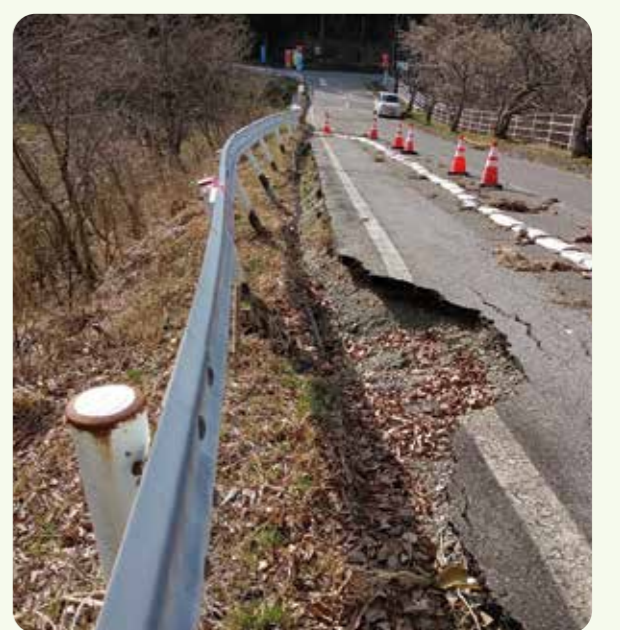
路肩が崩落した町道日南邑線
