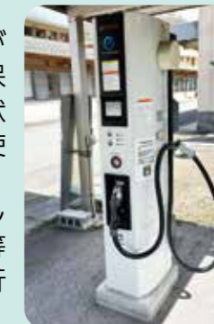
役場の充電設備
