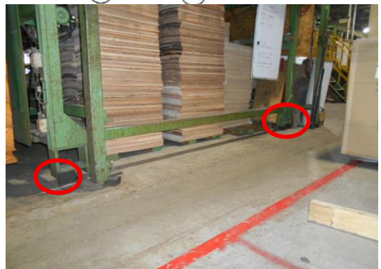
CLP-8000 地盤沈下 約1~6cm (地盤沈下進行により、単板挿入に上向き角度が生じている)
