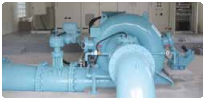
発電を始めた新石見小水力発電所
