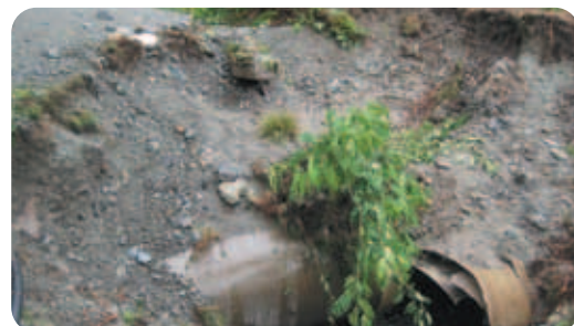
導水管の破損箇所
