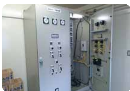
更新前の施設監視装置
