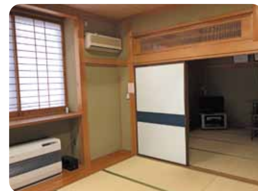
避難所に整備されたエアコン
