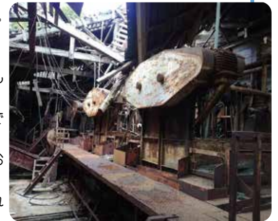
荒廃が進む若松鉱山
