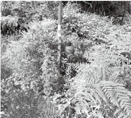
草に埋もれた消火栓
