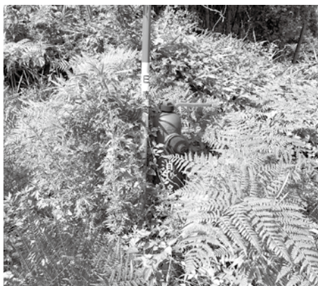
草に埋もれた消火栓
