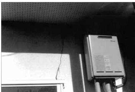
開口部の隅のわずかなひび割れ
