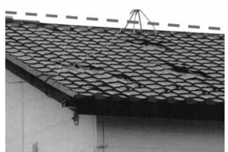
屋根瓦のズレ、損壊または落下
