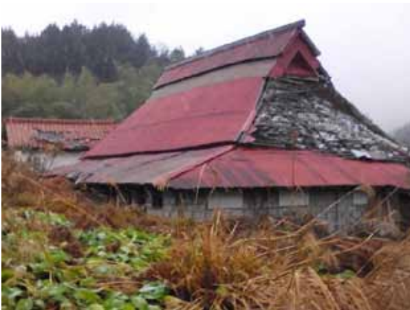
図10 危険家屋(空き家)の例
