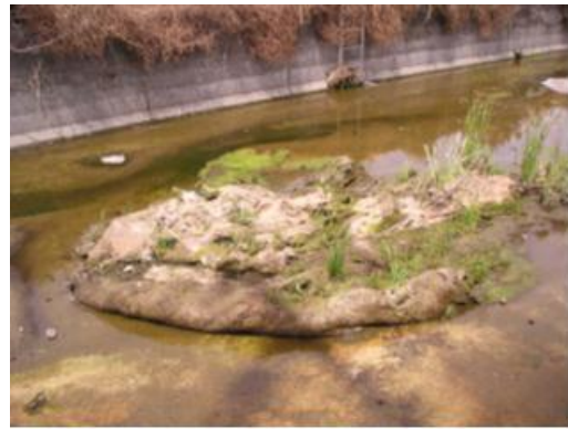
土砂の堆積状況
