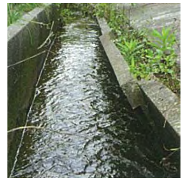
側壁の倒壊（側溝）
