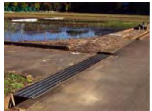
コンクリート蓋とグレーチング
