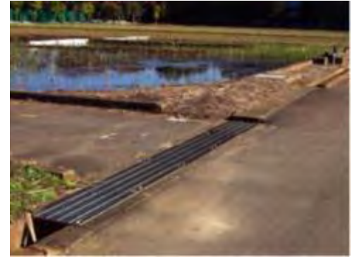
コンクリート蓋とグレーチング
