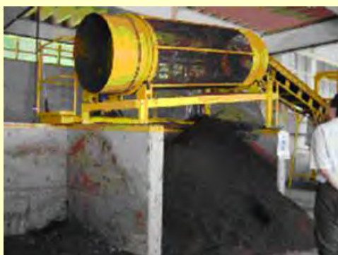
堆肥プラント
