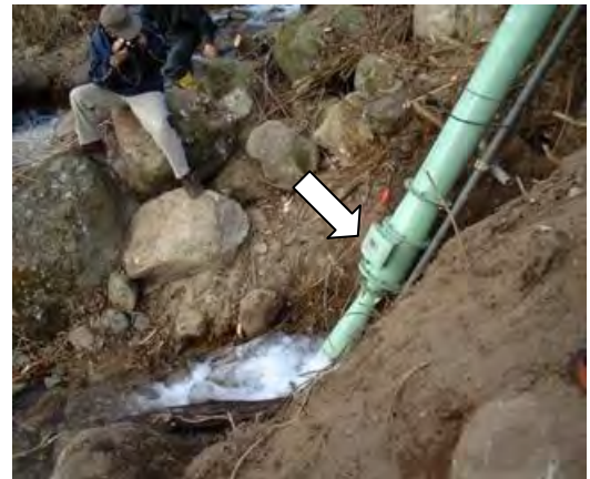
簡易な発電機 (図の矢印)
