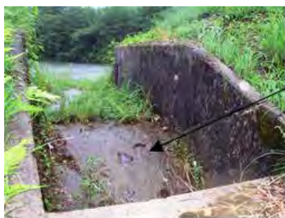
洪水吐底板（コンクリート）の欠損
