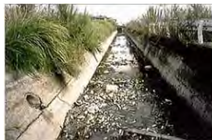
水量が減少した水路
