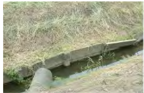
水路側壁のはらみの状況
