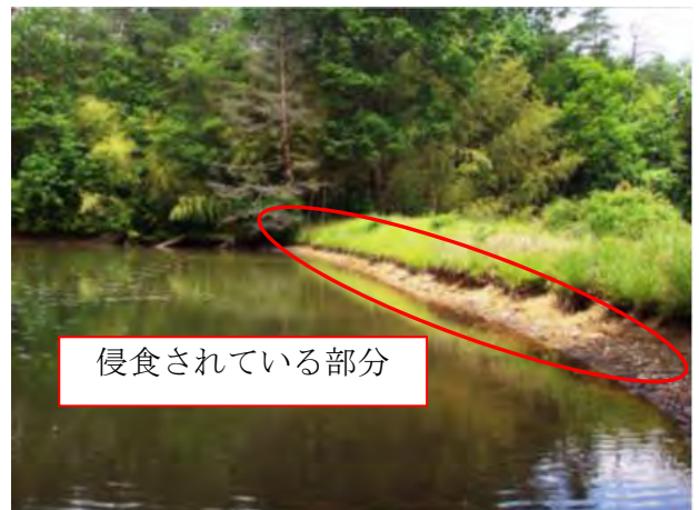
侵食が生じているため池堤体
