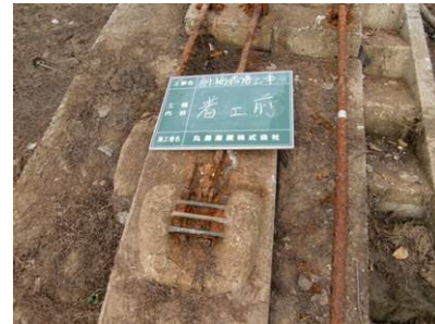
ため池における 老朽化したゲート
