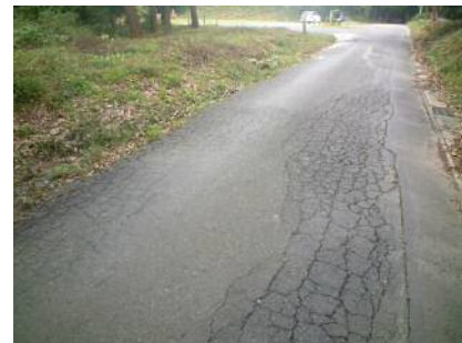
アスファルト舗装の老朽化
