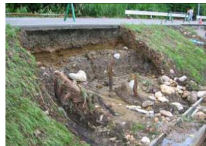
道路法面の崩壊
