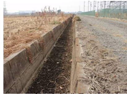
安全施設がない水路
