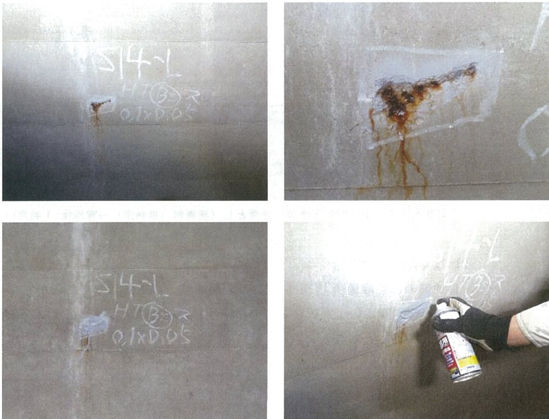
写真 5.3 若杉 鉄筋露出箇所 (S014 Ⅱb 判定 上: 措置前、下: 措置後)
